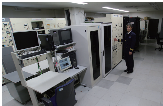
レーダー映像や無線を送受信する装置が集まる機械室
