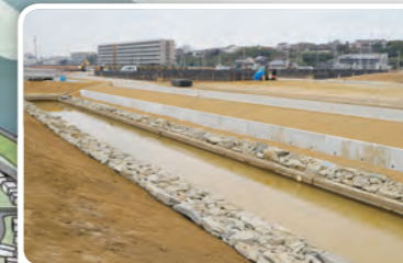
公園の北側を流れる「聖人堀」。震災前はコンクリートのふたで閉じられていた、暗きよだった水路だ。
