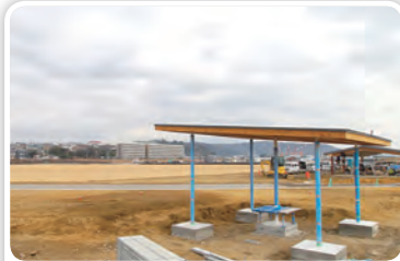
芝生が整備された四丁目北広場。あずまやも設置され、市民が憩える場として利用される。
