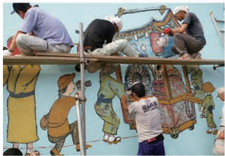
鯖街道沿いにあるシンボルの巨大壁画を今年の夏、11年ぶりに塗り直しました
